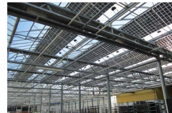
Foto: Kassen met zonnepanelen (bron: solarkassen - gakon)
