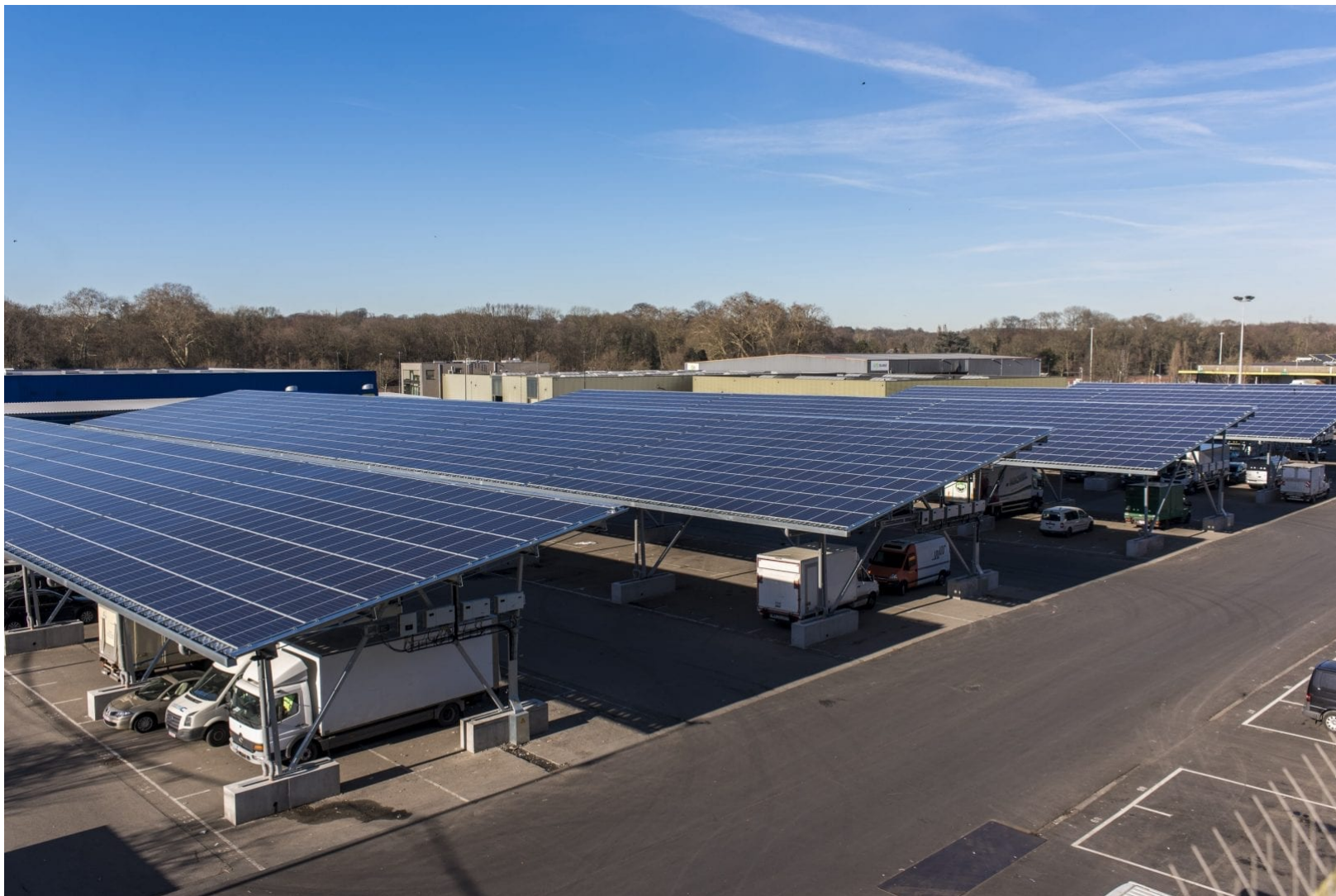
Overkappingen met zonnepanelen
